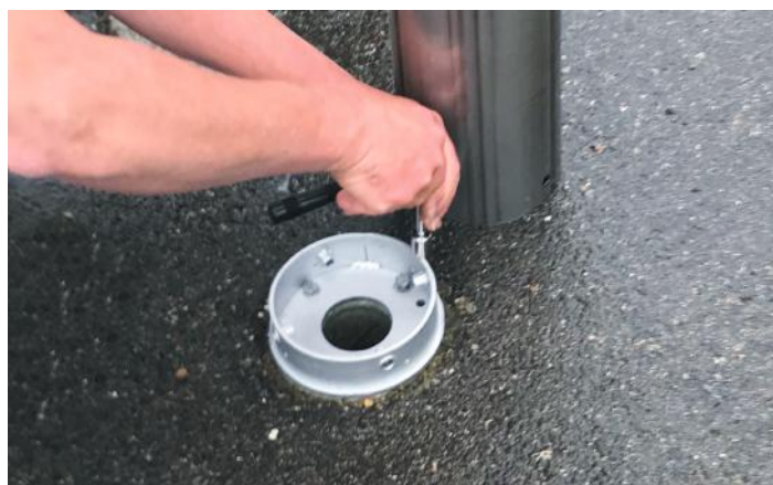
Installation facile avec le pieu ou le fourreau d'ancrage FERRADIX®, ici dans l'enrobé.
